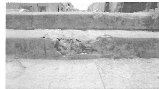
DELAMINACIÓN Y EXFOLIACIÓN EN ESCALONES
