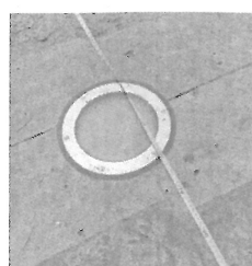
LUMINARIAS DE LED EN PISO DE CANTERA.
