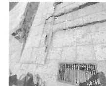
FALTANTE DE PIEZAS EN RAMPA
