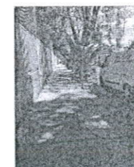
Fotografía 1: Estado actual de banqueta sobre la calle margarita maza (de poniente a oriente).
