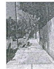
Fotografía 5: Estado actual de banqueta sobre la calle margarita maza (de oriente a poniente).
