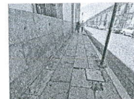
Foto 5. Agrietamientos en tapas de registro de 60 x 40 cm, provocados por sismo, y falta de mantenimiento.
