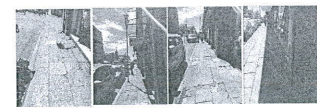
FOTOGRAFÍA 1-4. Estado actual de banquetas sobre la calle de 20 de Noviembre entre las calle de Valerio Trujano y Las Casas.
