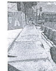
Fotografía 3: Estado actual de banqueta sobre la calle margarita maza (de poniente a oriente).
